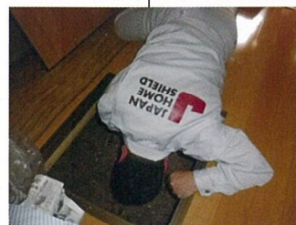
■ 土台のひび割れ、劣化
