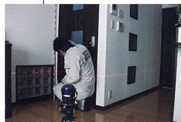
■ 床の著しい沈み、傾斜
